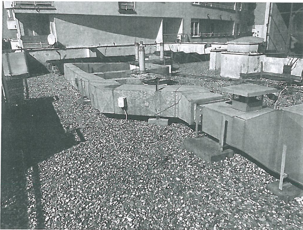
Fot. 4-57. Widok na wentylator wywiewny oraz przebieg kanałów systemu wywiewnego budynku mieszkalnego M1 (ozn. w opinii W9) – widoczna rdza na płaszczu z blachy - przy al. KEN 36a.
