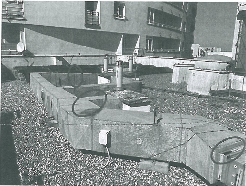
Fot. 4-58. Widok na przebieg kanałów systemu wywiewnego budynku mieszkalnego M1 (ozn. w opinii W9) – widoczna rdza na płaszczu z blachy, widoczne uszkodzenie króćca elastycznego przyłączeniowego z wentylatorem – przy al. KEN 36a.
