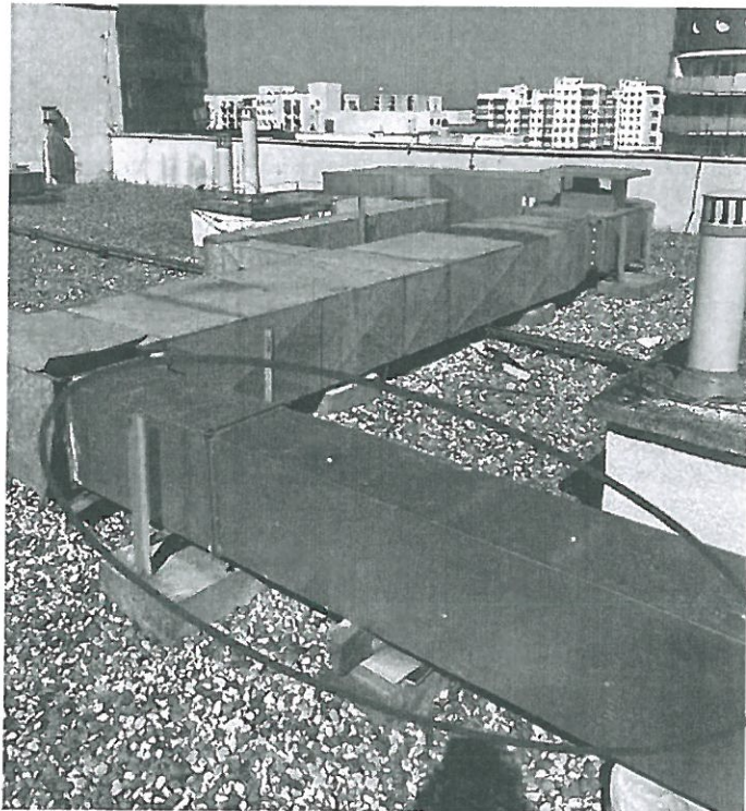
Fot. 4-51. Widok na wentylator wyciągowy systemu wywiewnego budynku mieszkalnego M1 (oznaczenie w opinii W8) – widoczny brak płaszcza z blachy z izolacją (ozn. czerwona elipsa) - przy al. KEN 36a.
