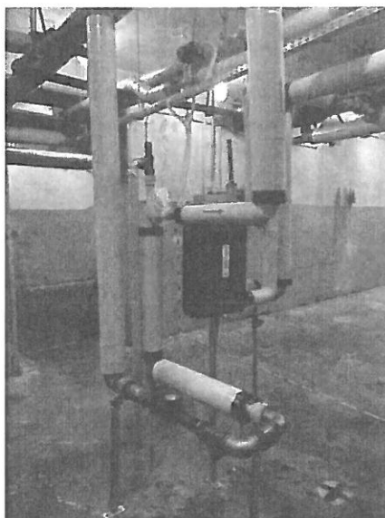
Fot. 3.1. Przykład węzła z płytowym, dwustopniowym wymiennikiem przepływowym.
